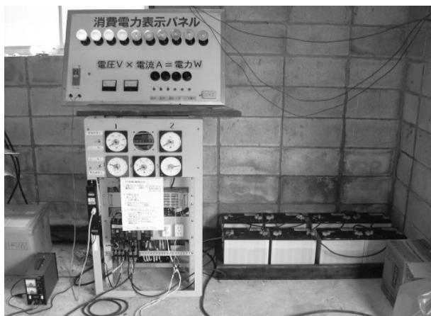
■消費電力表示パネルと蓄電設備
